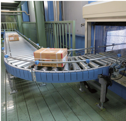
カーブ搬送ライン
