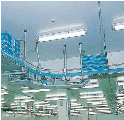
天井吊りライン
