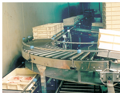
PCセンターの搬送ライン
