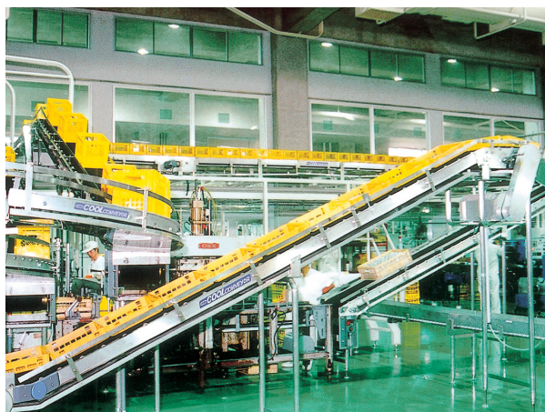
コンテナの搬送ライン
